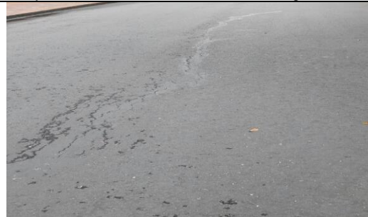
Foto 13. Panorámica General Intervención Sector La Carolina CIV 1004333– Presenta fisuras longitudinales
