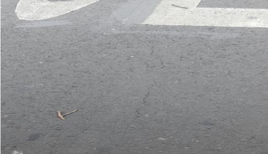
Foto 11. Panorámica General Intervención Sector Calleja CIV 1004062 – Presenta fisuras longitudinales
